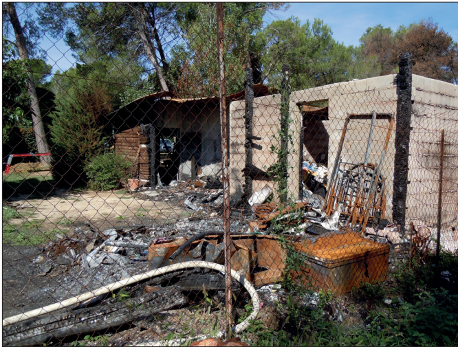
Fot. 25 - Dommages sur habitation - Uchaux France (Source: C. Bouillon).
