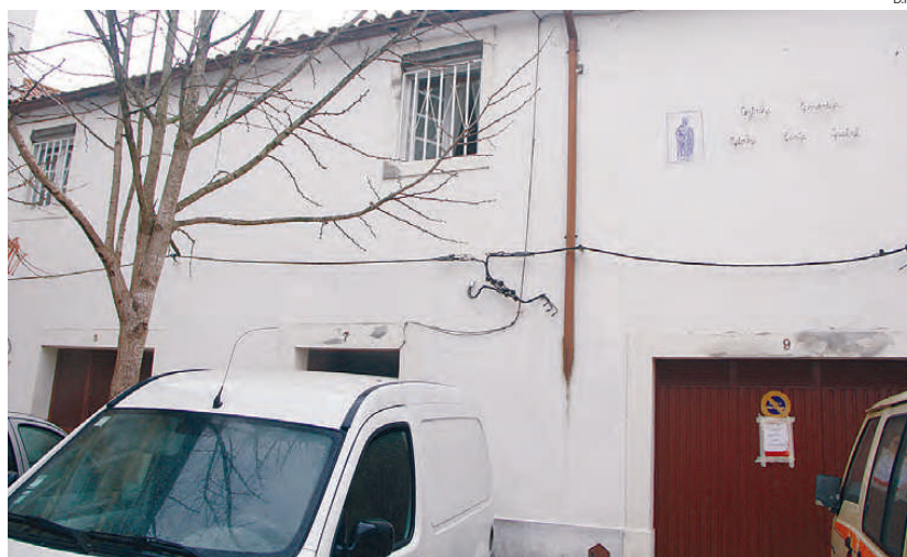
Edifício da Associação das Cozinhas Económicas, na Baixa de Coimbra, está a necessitar de obras
