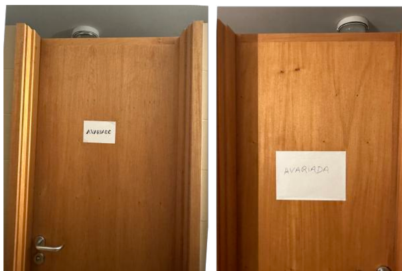
WCs Bloco A (Feminino e Masculino)
